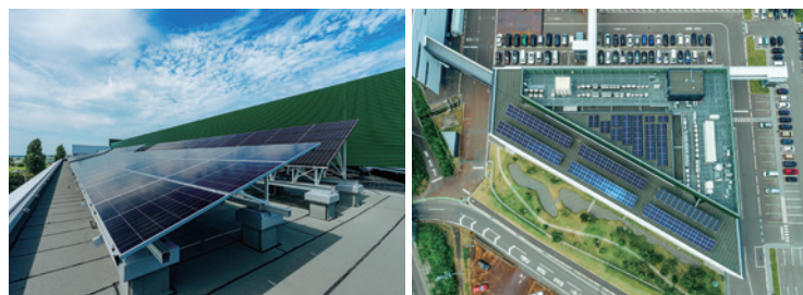
24号棟太陽光発電設備
