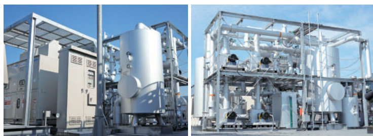
熱回収ヒートポンプ設備全景
