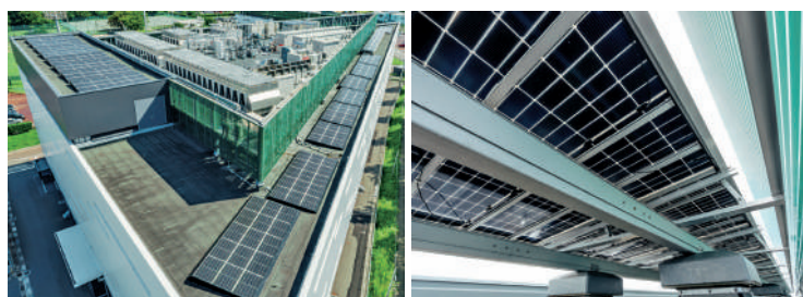
21号棟太陽光発電設備
