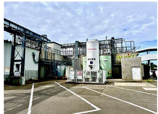
排水処理施設（本社工場）
