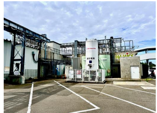
排水処理施設（本社工場）
