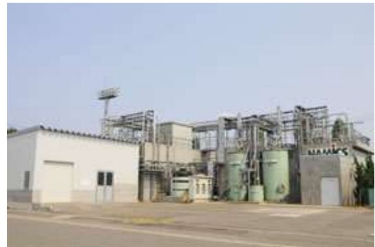
排水処理施設（本社工場）
