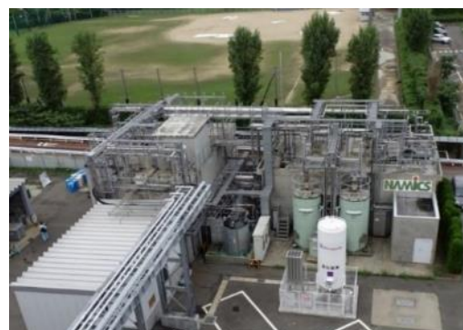
排水処理施設（本社工場）
