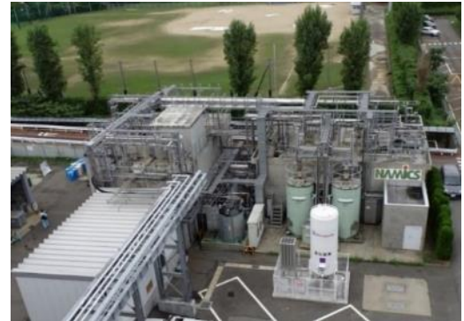
排水処理施設（本社工場）
