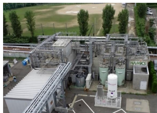
排水処理施設（本社工場）
